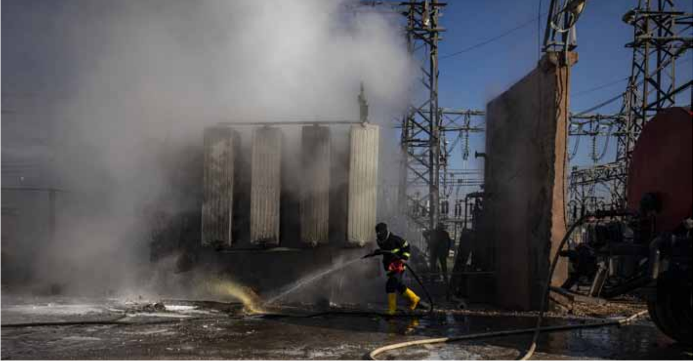
عناصر إطفاء سوريون كرد يطفئون النيران المشتعلة في محطة كهرباء في القامشلي، التي استهدفتها مسيرات تركية بحسب تقارير في 15 يناير
